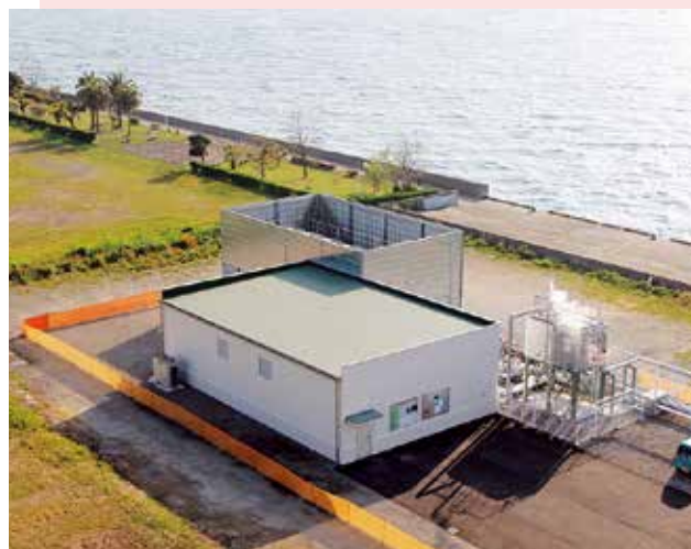
環境科学部が社団法人小浜温泉エネルギー等とともに 実証実験をすすめる雲仙市小浜温泉の未利用温泉水発電施設
