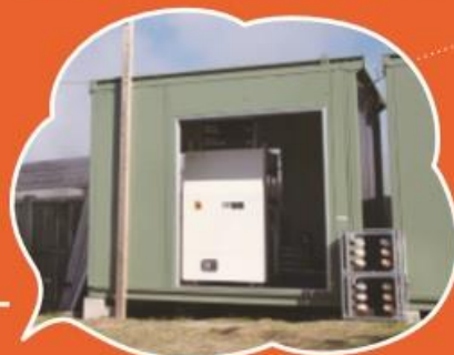
小浜温泉の足場に設置した新設備 「可搬型小型発電システム」
